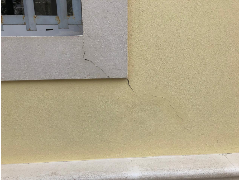
Figura 1-Fissuras no canto da Janela (Fonte: Iphone 8)
