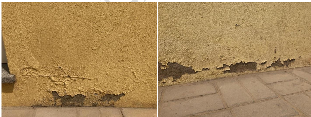
Figura 2- Excesso de humidade por capilaridade (fonte: Iphone 8)
