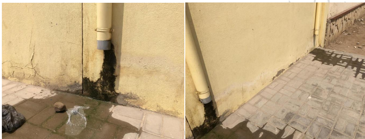
Figura 3- Excesso de humidade com manchas na parede (Fonte: Iphone 8)
