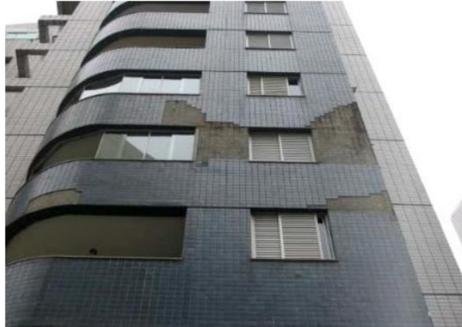
Figura 2: Deslocamento de peças cerâmicas em fachada.
