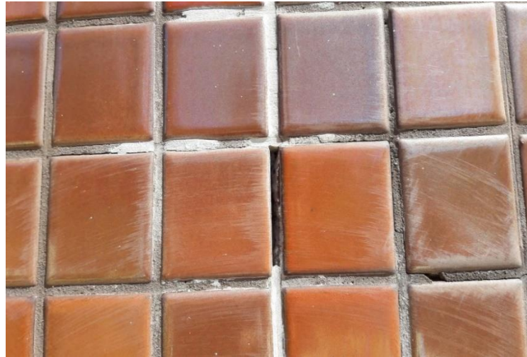
Figura 6: Falhas de rejunte
