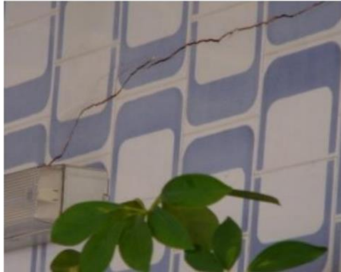
Figura 7: Fissuras no revestimento cerâmico
