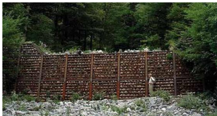
Figura 1- Muro de contenção de fluxo de detritos na Bacia Kamikochi, Japão. (Manual de deslizamentos)
