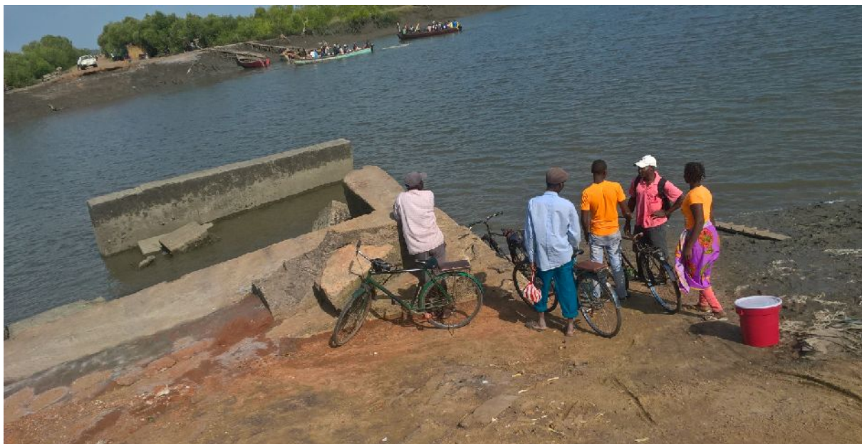
Depois do desabamento da ponte sobre o rio Chipaca em Setembro de 2018, fonte o autor
