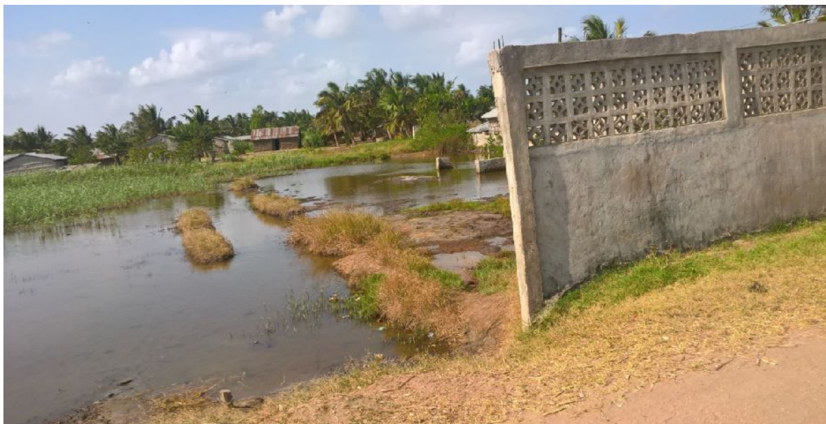
Invasão das águas a uma residência em dias de maré alta. Fonte o autor
