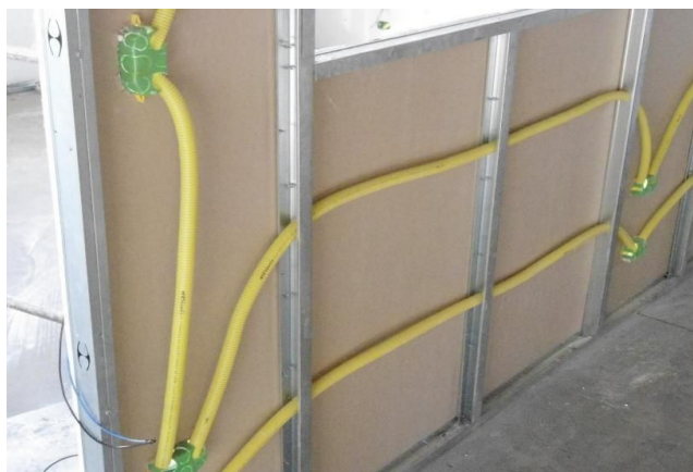
Figura 12 – Eletrodutos flexíveis nas Instalações elétricas
