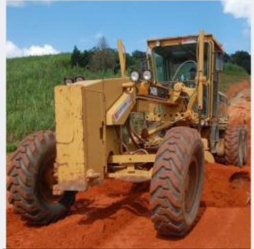
Motoniveladora realizando o serviço de espalhamento do material de base para estrada..
