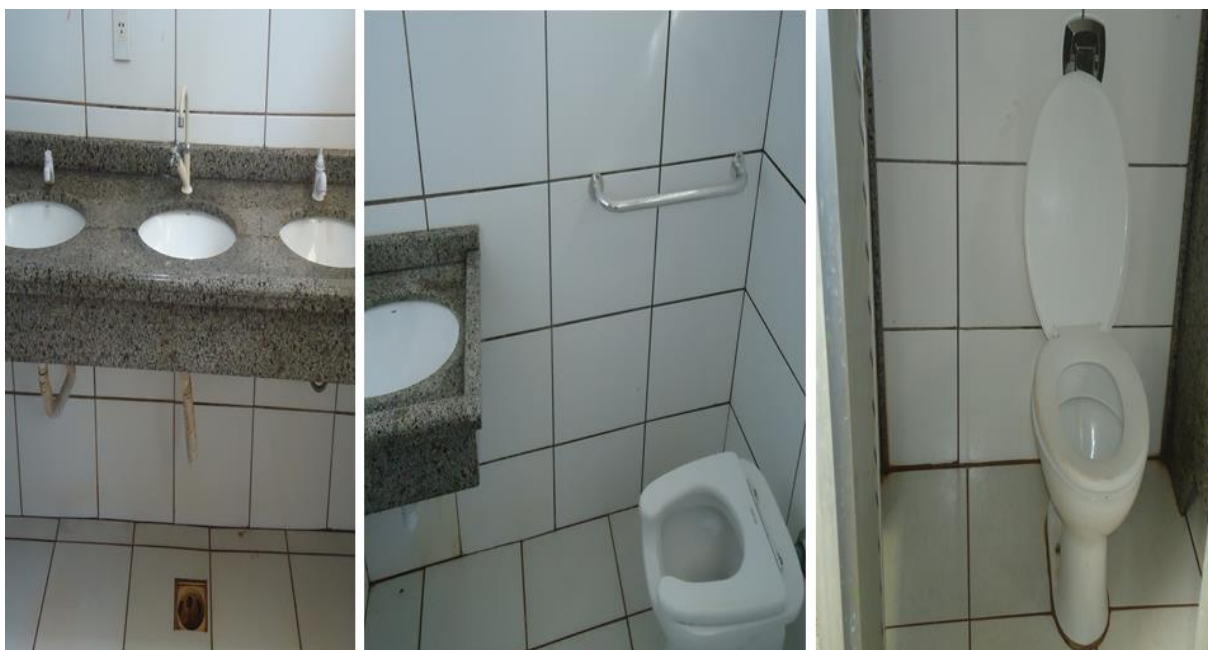
Figura 8: Pia e sanitário
