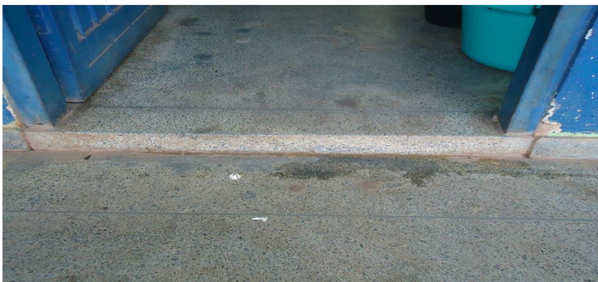
Figura 3: Falta de acessibilidade na entrada de sala de aula
