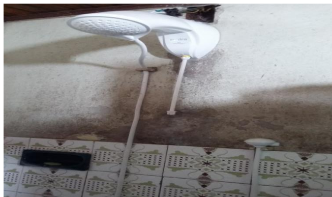
Figura 2: Pintura de um banheiro residencial escamando e com umidade excessiva.
