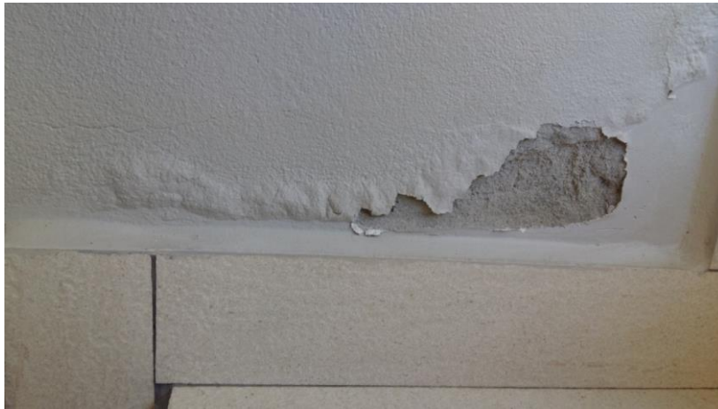
Figura 3: Parede externa da residência com infiltração.
