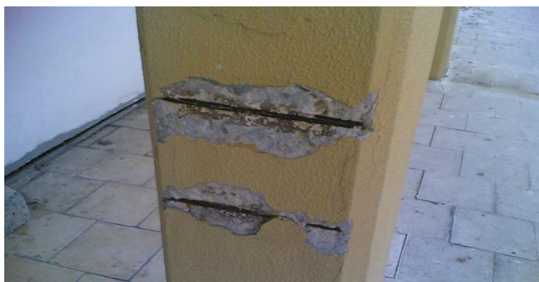
Figura 1: Corrosão de armaduras em pilares.
