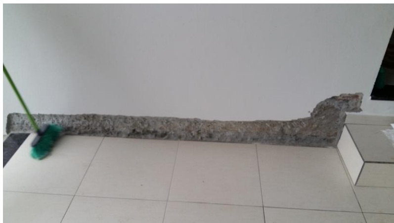
Figura 6: Parede da edificação com o reboco totalmente retirado.
