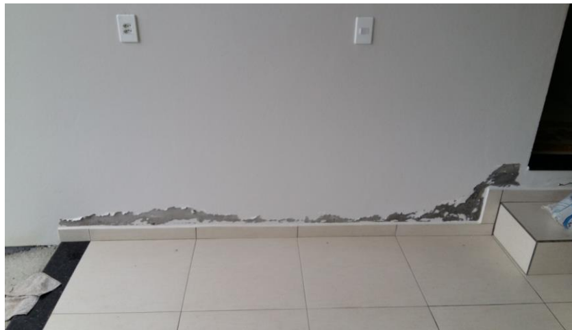
Figura 4: Parede externa da residência com infiltração.
