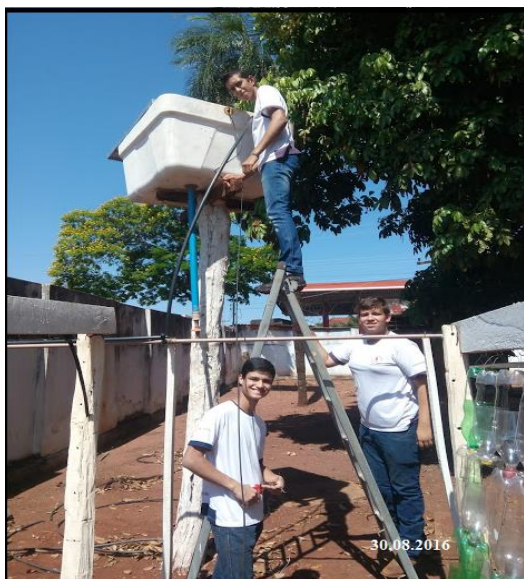
Figura 3: Instalação de caixa distribuidora pelos educandos do Colégio Estadual Independência - agosto de 2016.
