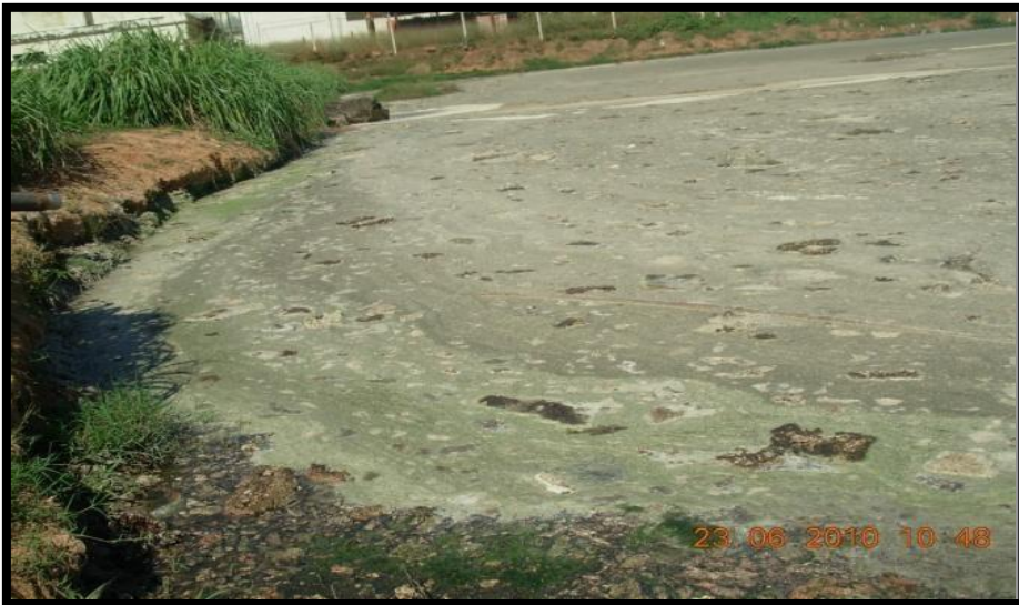
Figura 04: 1ª lagoa de decantação.
