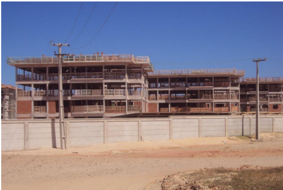
Figura 02 - Registro de um empreendimento e, fase de instalação em Aquiraz, evidenciando o porte do aparelho. Fonte: Pesquisa direta (2014)
