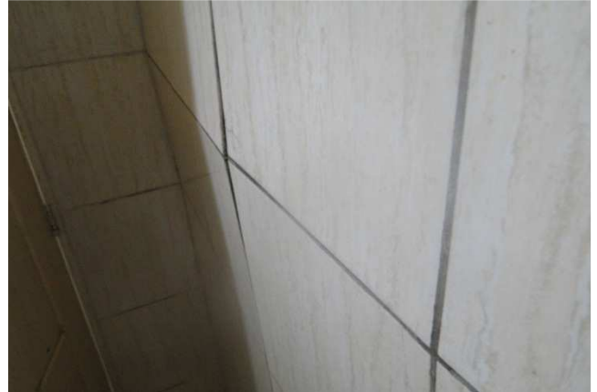
Foto 14 - Revestimento Cerâmico – Banheiros - Descolamento
