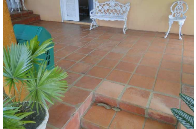
Foto 08 - Piso Inferior Térreo - Trincas
