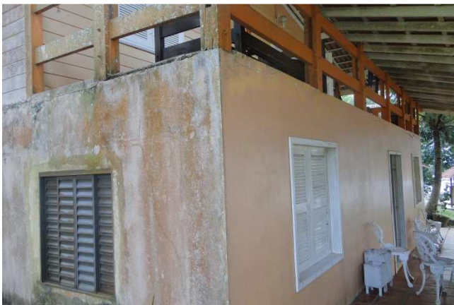
Foto 03 - Vista Lateral Direita – Rachaduras na Laje Superior
