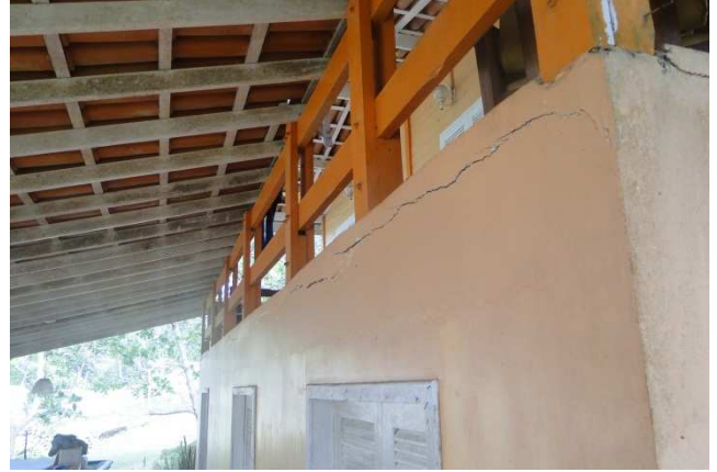
Foto 02 - Vista Lateral Esquerda – Detalhe das Rachaduras na Laje Superior
