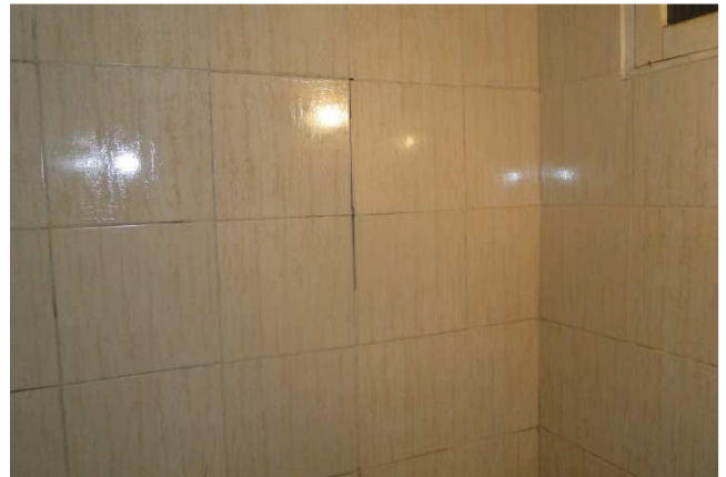
Foto 16 - Revestimento Cerâmico – Banheiros - Descolamento
