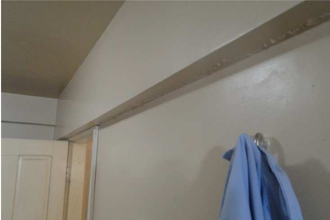
Foto 13 - Laje Superior – Base Inferior - Trincas
