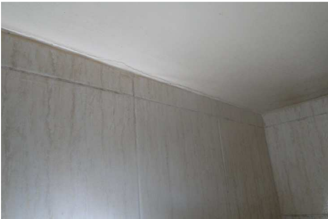
Foto 15 - Laje Superior – Base Inferior - Trincas
