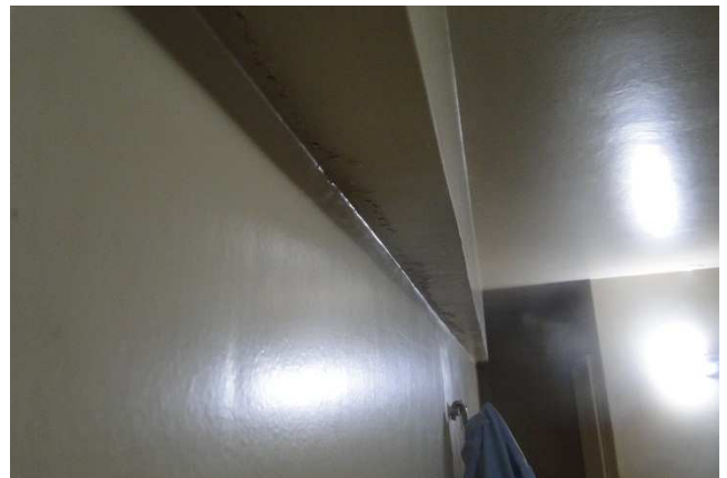
Foto 12 - Laje Superior - Base Inferior - Trincas
