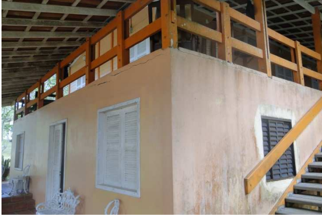
Foto 01 - Vista Lateral Esquerda – Rachaduras na Laje Superior
