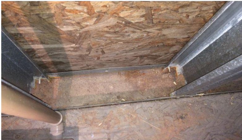
Figura 6 – Perfil com corrosão branca.
