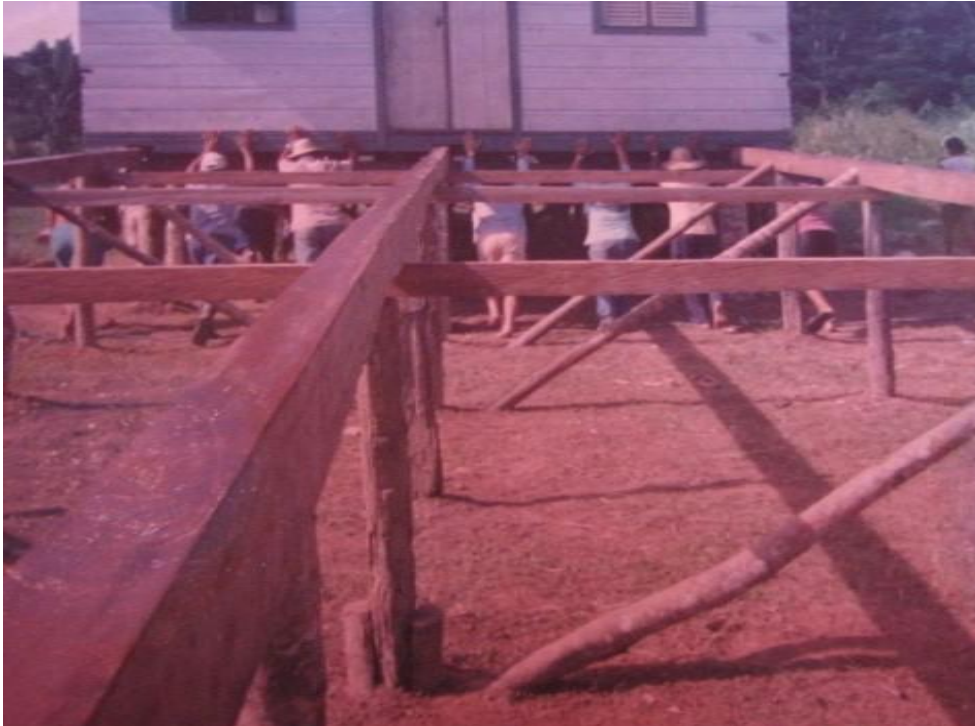
Figura 06 - Casa sendo empurrada sobre os trilhos para o interior do terreno. Fonte: Arquivo da família Souza reproduzido por Cleusa Mello, 2010.
