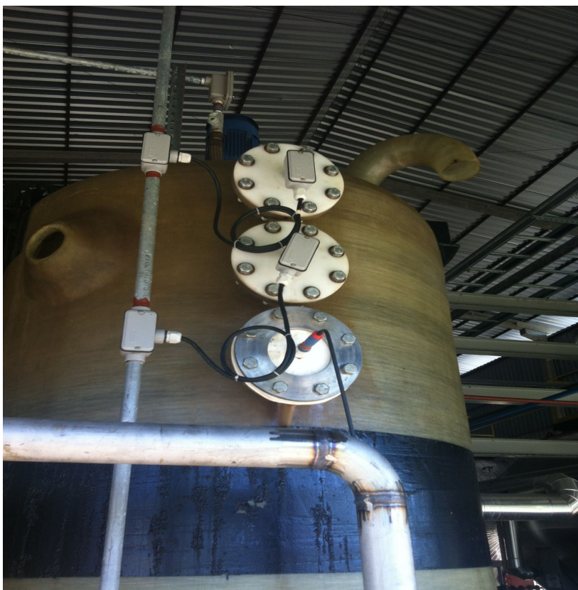
Fotografia 08 – Sensores de Nível HL e HHL e sensor de PH e Temperatura.
