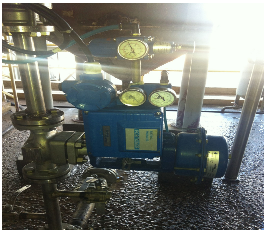
Fotografia 07 – Válvula de Controle
