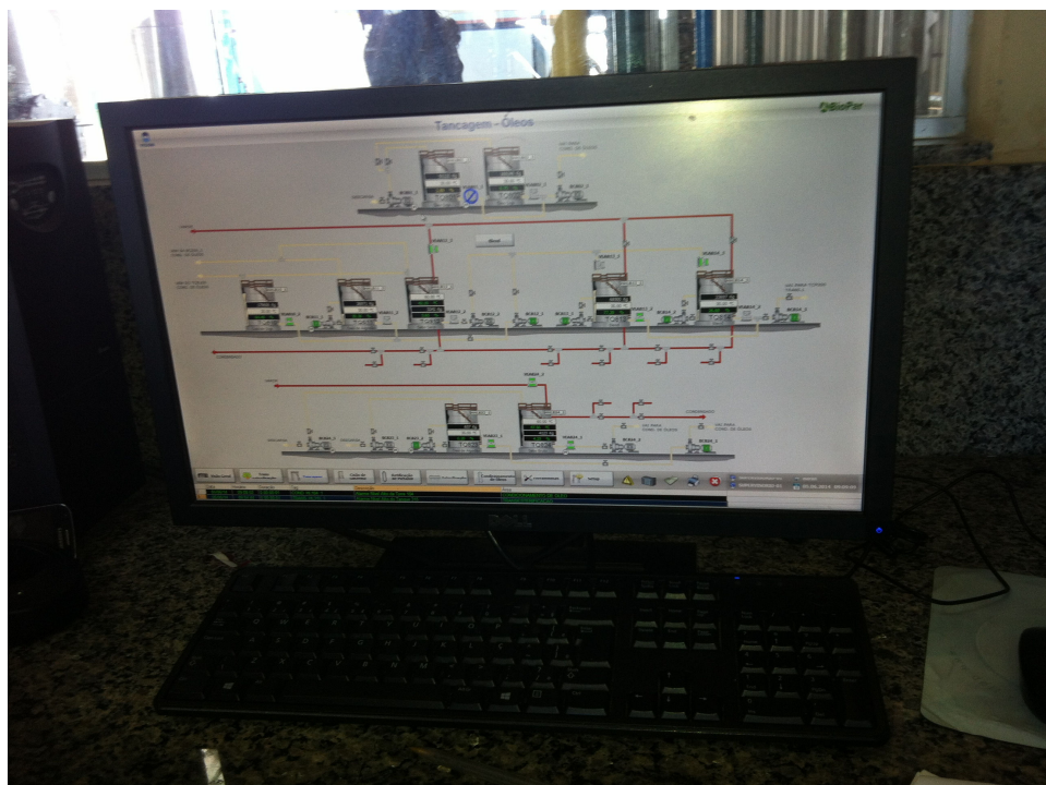
Fotografia 09 – Terminal com Supervisório em Funcionamento
