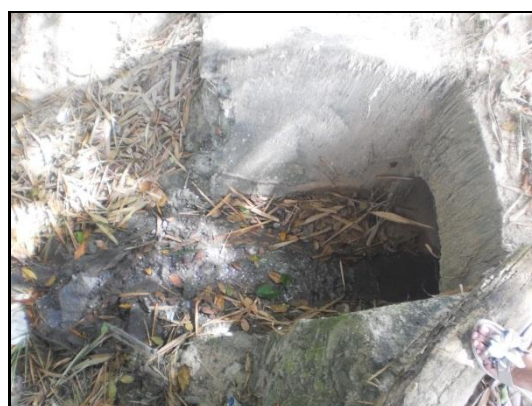
Figura 20: Galeria de Águas Pluviais com esgoto, sinal de ligações clandestinas.
